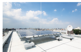
太陽光発電設備 (コーシャハイム向原・板橋区)
